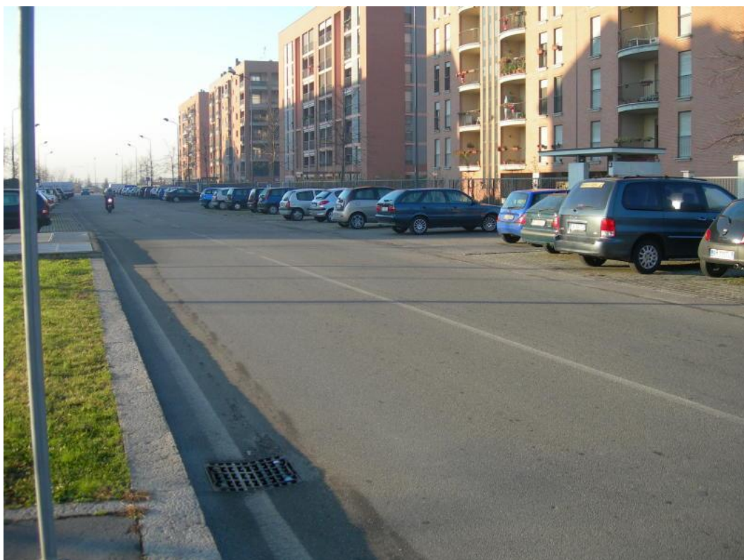
Foto 3 e 4 – Via Donna Prassede in prossimità del supermercato e dell'area parcheggio: segnaletica orizzontale sbiadita e da rifare
