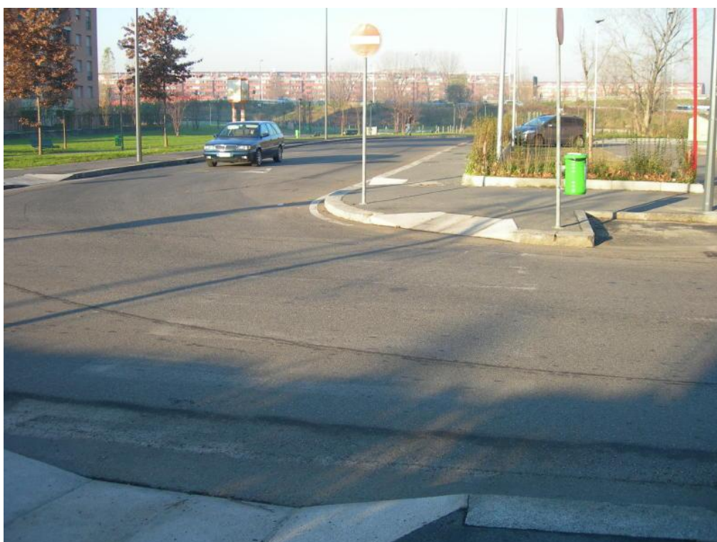
Foto 1 e 2 - Via Donna Prassede in prossimità del supermercato e dell'area parcheggio: segnaletica orizzontale sbiadita e da rifare
